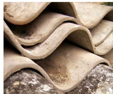
Asbesthaltige Eternitplatten dürfen seit 1993 nicht mehr genutzt werden, eine Entsorgung mit Bauschutt ist verboten
