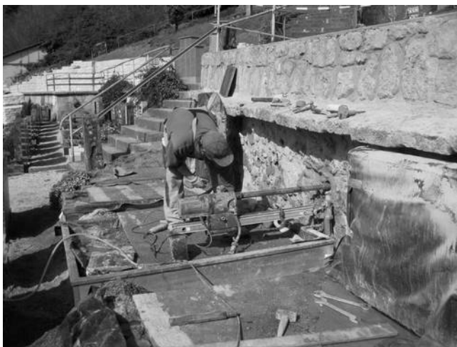
Bauarbeiter der Fa. BST Saniertechnik mit einem Bohrgerät an der Stützmauer neben der Kunigundenkirche
